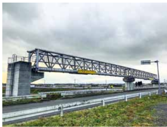
田村町大善寺にある水管橋
