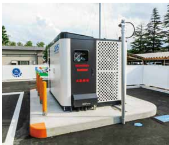
市役所本庁舎東側にある郡山市水素ステーション
