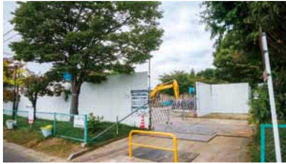
安積町にある巳六段公園につくられた詰替場
